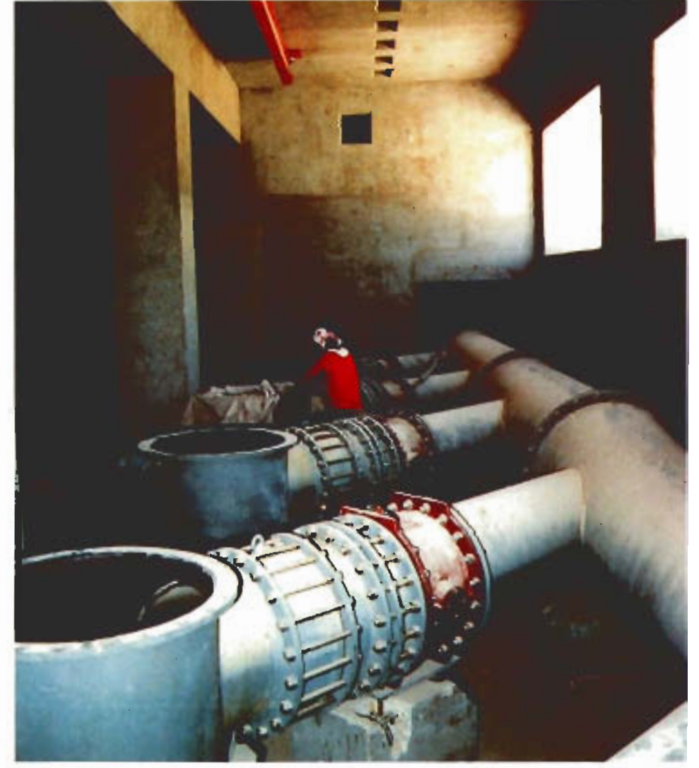
محطة معالجة المياه الأرضية في طريق الملك فهد
