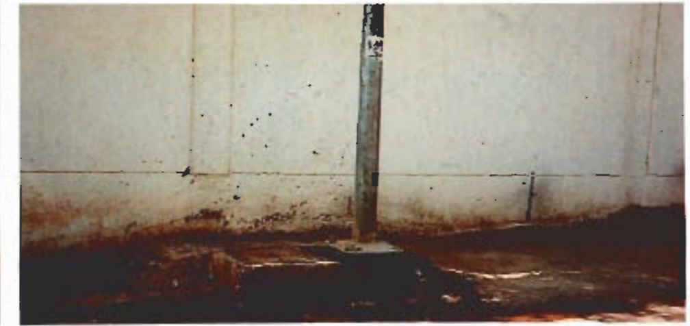
المياه تتسرب من قاعدة عمود الكهرباء
