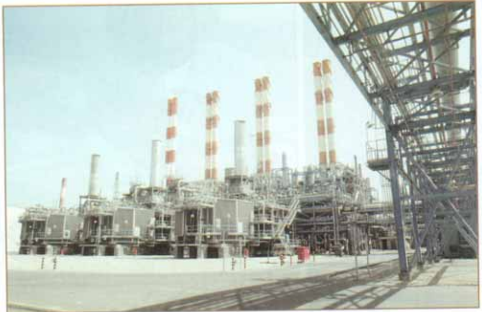
▲ إحدى محطات توليد الطاقة الكهربائية الحديثة بالرياض
