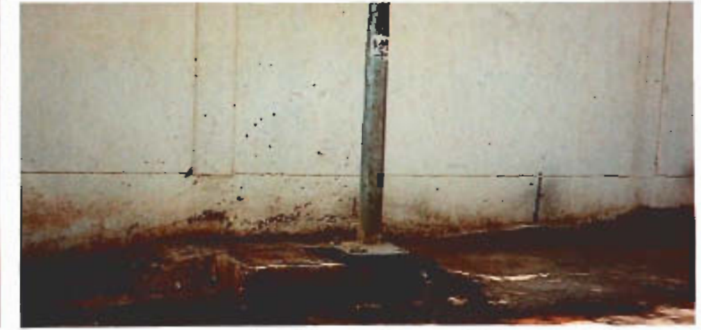
المياه تتسرب من قاعدة عمود الكهرباء
