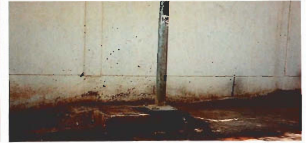
المياه تتسرب من قاعدة عمود الكهرباء
